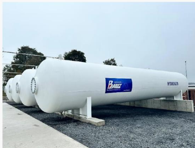
Zásobníky vodíku 4x95 m 3
