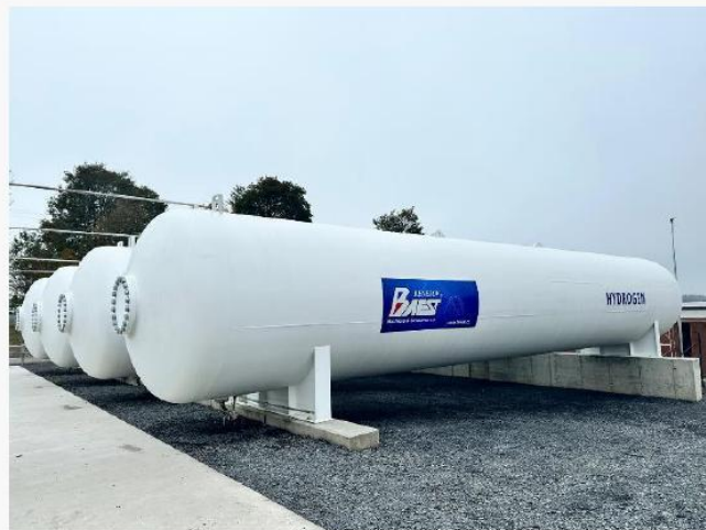
Zásobníky vodíku 4x95 m 3
